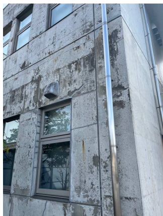
①外壁の劣化 幡豆いきいきセンター 外壁のひび割れ
