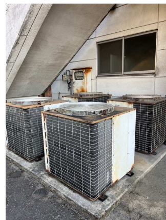
③設備の劣化 南館多目的ホール空調故障。図書館、児童館も不良
