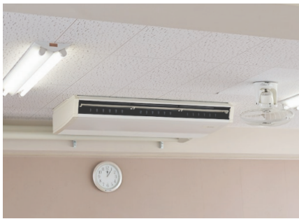
普通教室に設置されたエアコン (写真は三和小学校)
