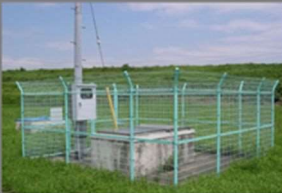
取水井（深井戸）
