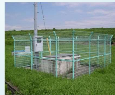
取水井（深井戸）
