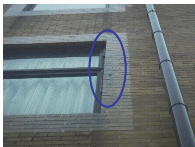
タイルの浮きやひび割れ
