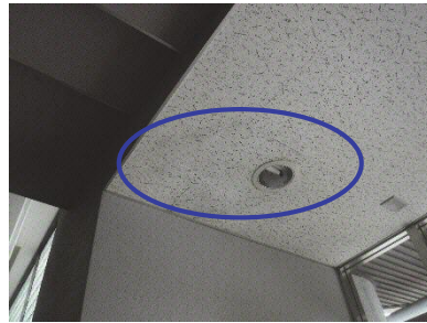
入り口付近の雨漏り痕
