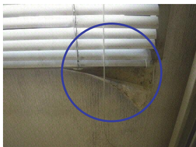
北面の窓周りからの雨漏り痕
