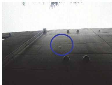
外壁塗装面の膨れ
