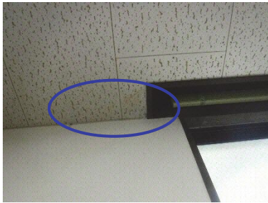
事務所の雨漏り痕
