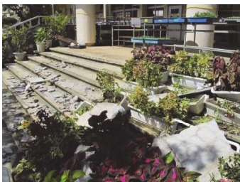
外壁モルタルが剥落 児童が軽傷
