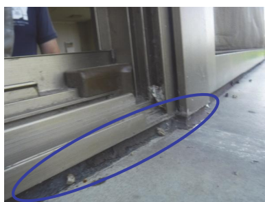
窓枠目地材の劣化
