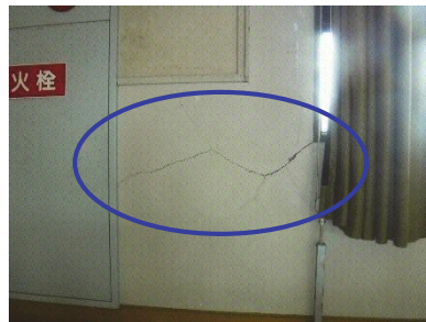
外壁内側のひび割れ
