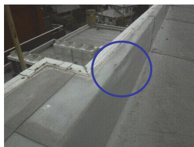
シート防水の部分的な破れ
