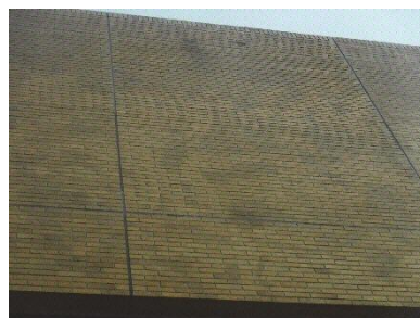
タイルの浮きの疑い
