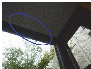
渡り廊下の雨漏り痕
