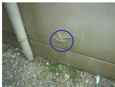
外壁塗装面の膨れ
