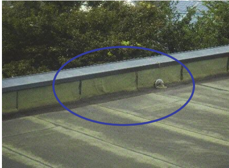
屋根材の劣化（防水層の膨れ）
