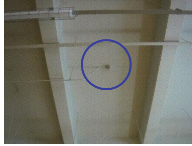
感知器周りの雨漏り痕（剣道場）
