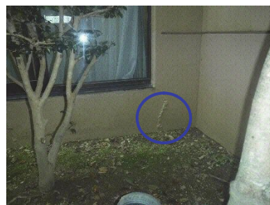
外壁塗装面の膨れ
