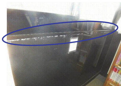
サッシからの雨漏り痕
