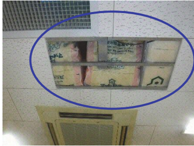
トップライト周りの雨漏り痕（図書室）
