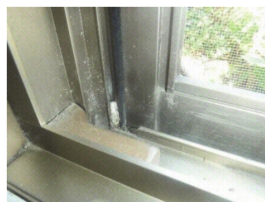
窓枠隙間からの雨漏り
