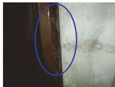
工事用扉の腐食
