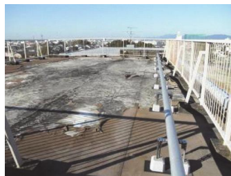
防水層の劣化 雨漏りにより内装を汚損
