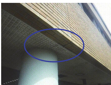
玄関口天井材の剥がれ
