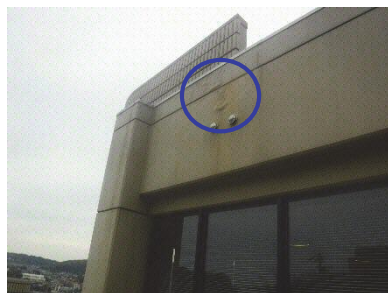
外壁塗装面の膨れ
