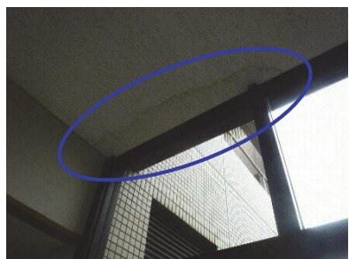
渡り廊下の雨漏り痕
