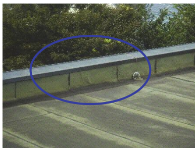
防水層の膨れ
