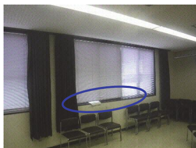
窓枠からの雨漏り痕
