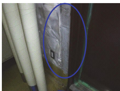
工事用扉周辺のタイルに浮き
