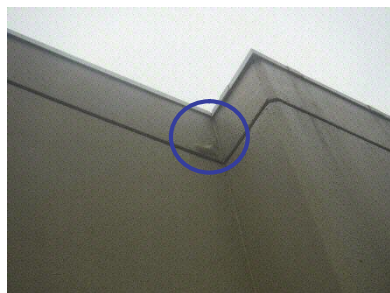
外壁塗装面の膨れ
