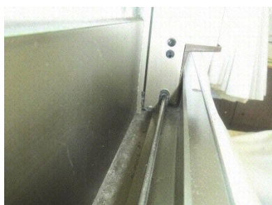
窓枠隙間からの雨漏り
