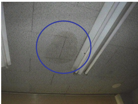
建築物内部への漏水・遊離石灰
