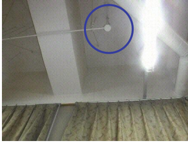
感知器周りの雨漏り痕（卓球場）
