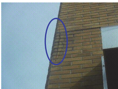
タイルの浮きやひび割れ
