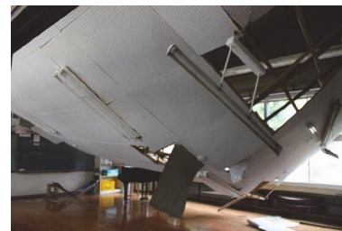
雨漏り 天井吊部材が腐食し落下
