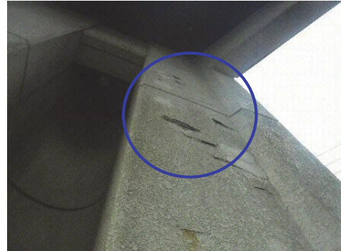
外壁の劣化（爆裂）
