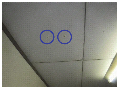
男子トイレの雨漏り痕
