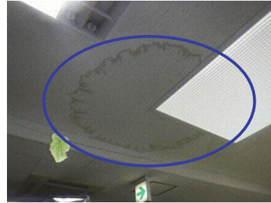
トップライト周りの雨漏り痕（ホール）
