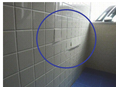
男子更衣室の内装タイルの浮き
