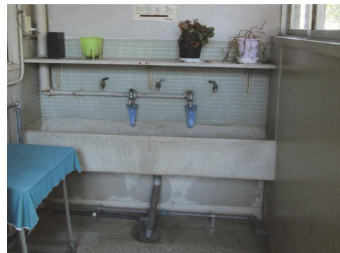
衛生設備の老朽化（水道の一部停止）
