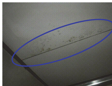
女子トイレの雨漏り痕
