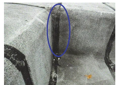
目地のひび割れ
