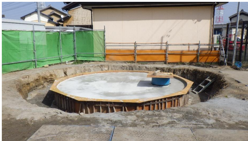
耐震性貯水槽
