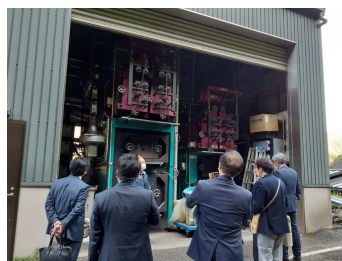
木質チップボイラーの様子
