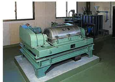
● 汚泥脱水設備
