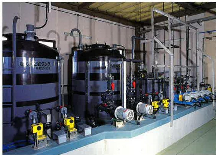
● 薬品注入設備
