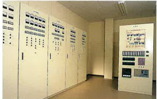
● 動力制御盤・監視盤
