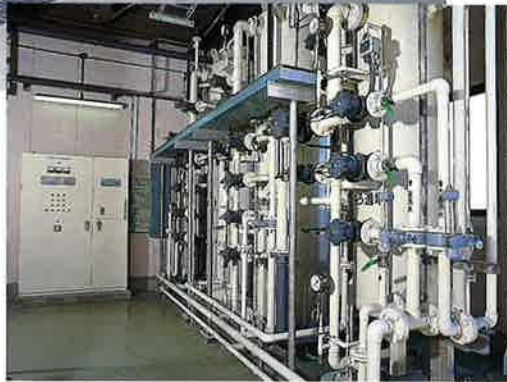
● 砂ろ過塔・活性炭吸着塔
