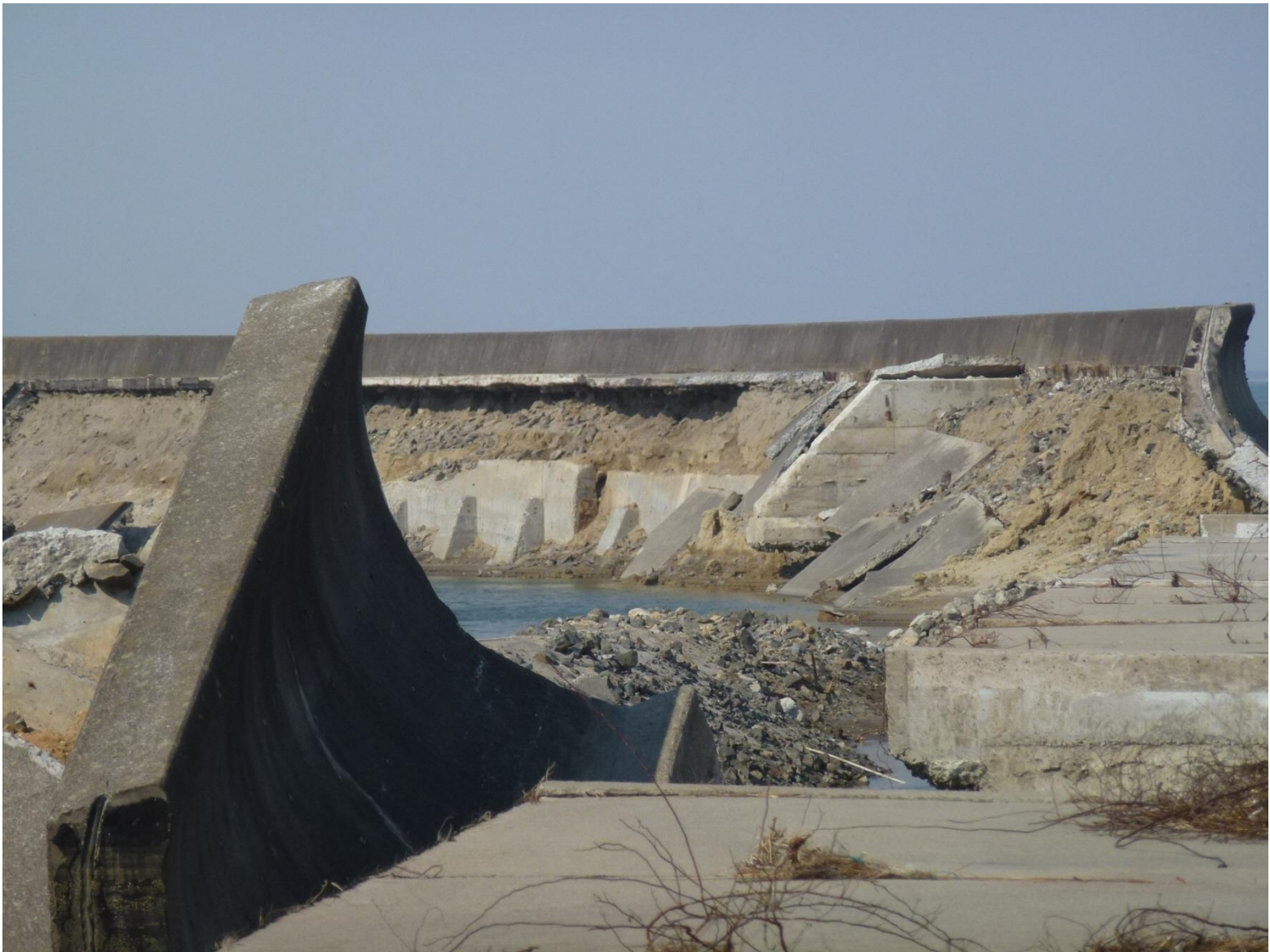
津波による浸食を受けた防潮堤（陸側が主に浸食されていた）
