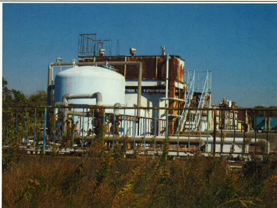
污水处理施設：機器は朽ち果て再稼働は不可能
