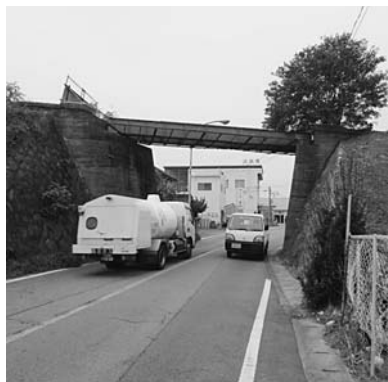
狭小で通行の妨げとなっている旧三河線ガード
