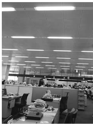
市役所事務室の照明
