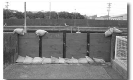
▲現在の寺津漁港の防潮扉。大型の木製で取り扱いが難しく、老朽化も激しいため、軽量で耐久性に優れた防潮扉に整備する。（寺津漁港防潮扉整備事業）
