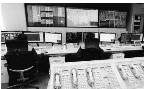
▲消防救急デジタル無線システムが整備される消防署通信指令室。
