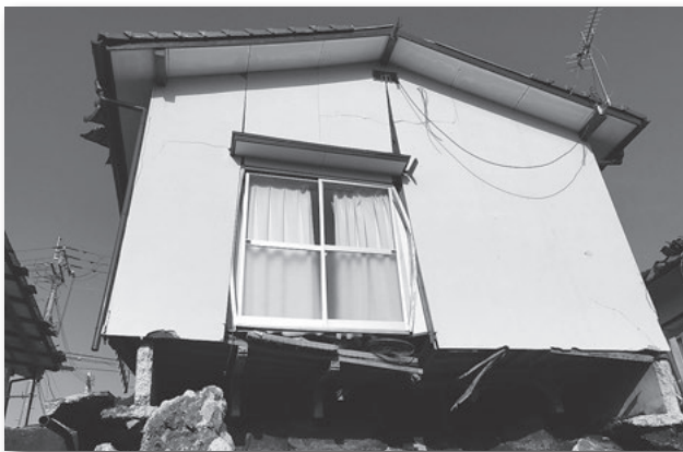
熊本地震の被害の様子
