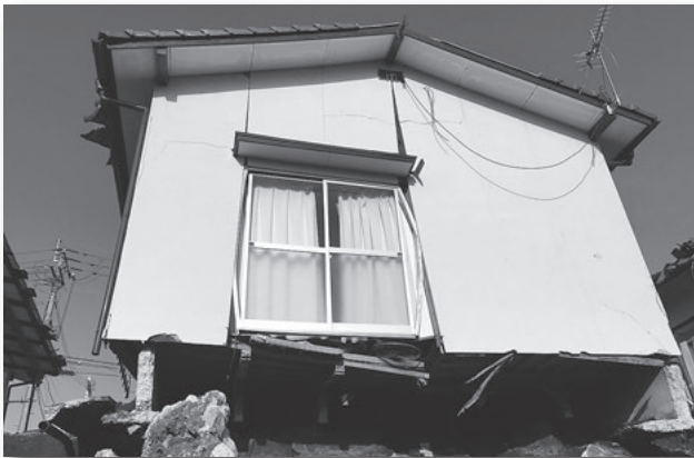
熊本地震の被害の様子
