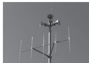
西尾地区の16カ所に整備されるデジタル方式の防災行政無線
