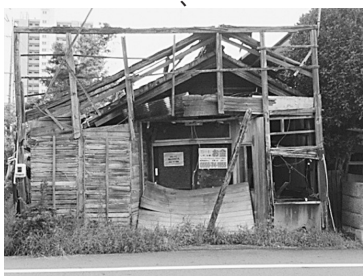
桜木町地内の空き家
