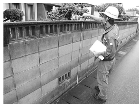
ブロック塀の簡易診断
