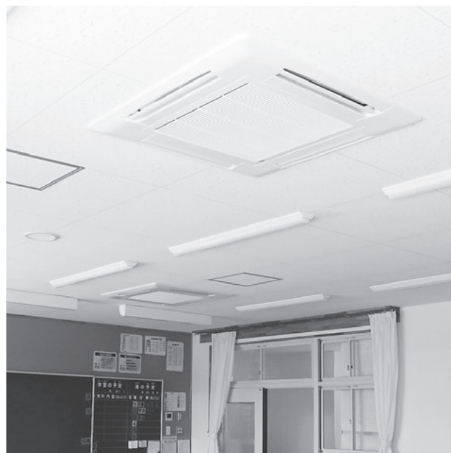
エアコンが設置されている矢田小学校の教室。未設置の教室には吊り下げ型のエアコンを設置する予定
