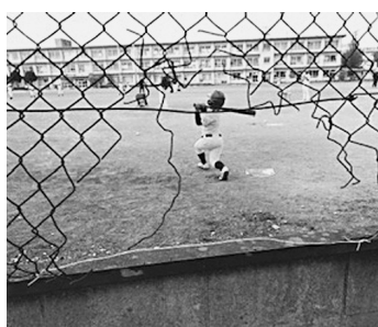
危険なままにされていた 寺津小学校のバックネット (平成30年6月に修理済み)
