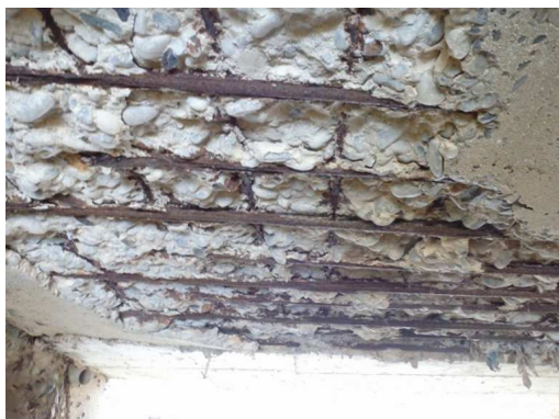
写真-2.1 塩害による鉄筋腐食
