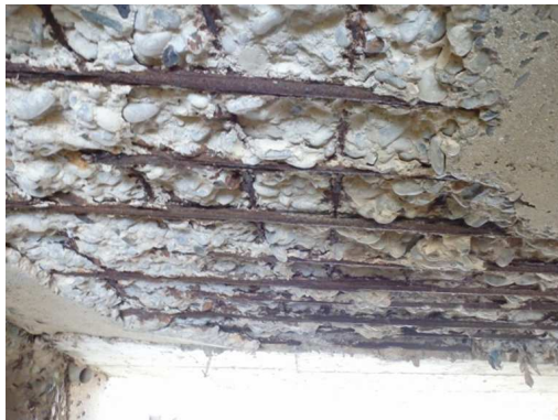
写-2.1 塩害による鉄筋腐食
