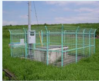
取水井（深井戸）
