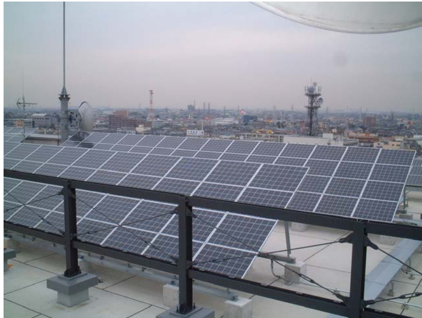
市役所屋上に設置された太陽光発電装置（発電能力50kw）
